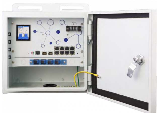
Switch in box stagno 8 porte 250mt + uplink fibra, IP55, cassetto ottico, magnetotermico
